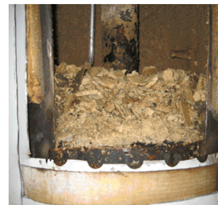
Calentador de agua abierto revelando acumulación de gran formación de sarro
