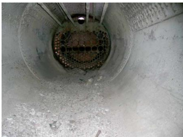
Tambor de vapor / agua de caldera con tubos de fuego retirados
